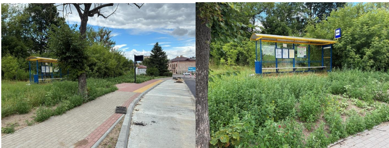
Rysunek 13. Modernizowana zatoka autobusowa w Siedlcach - wiata przystankowa na czas prac modernizacyjnych ustawiona w miejscu niezapewniającym dostępności dla osób o ograniczonej mobilności
