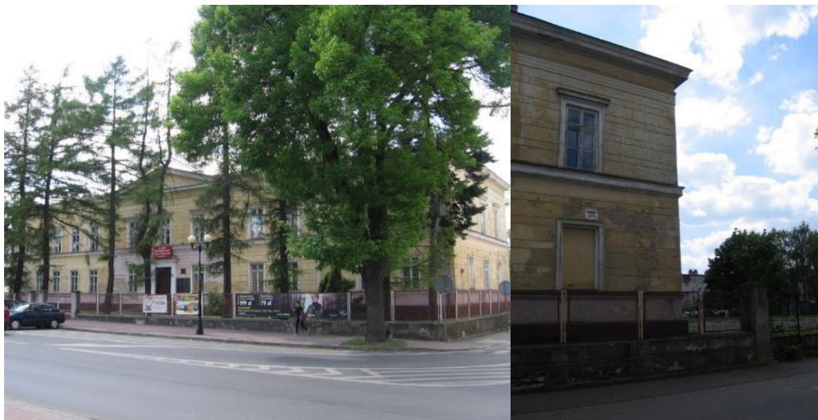
Fotografie: Widok na niszczący budynek byłego Liceum Ogólnokształcącego – widok od wejścia przy ul. Stanisława Konarskiego oraz widok ściany bocznej i ogrodzenia od ul. Mieczysława Asłanowicza
