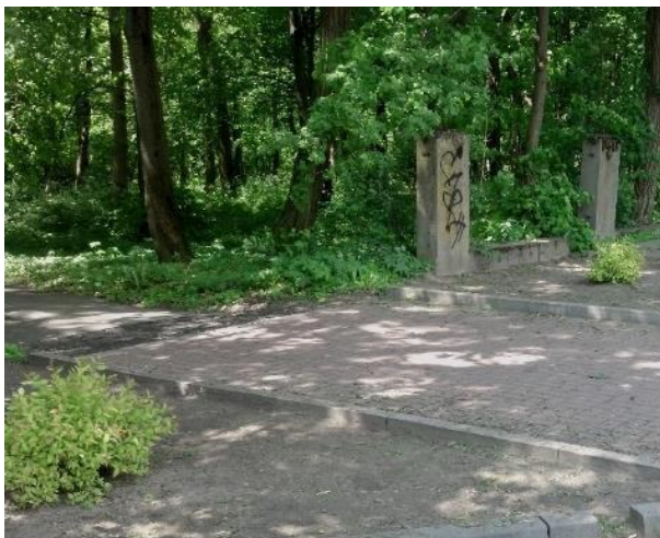
Fotografia: Zniszczone ogrodzenie Parku „Aleksandria” – wejście od ul. Bolesława Prusa
